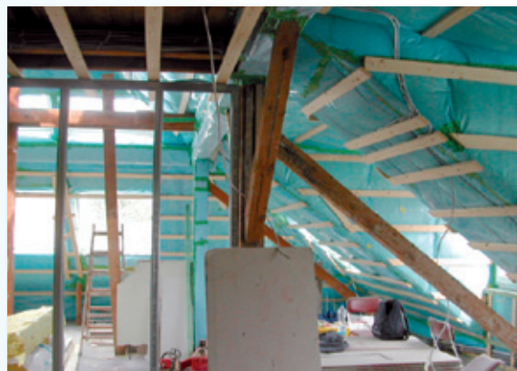
Le niveau étanche (film et panneaux bois) est encore visible. C'est le moment idéal pour un test BlowerDoor.
